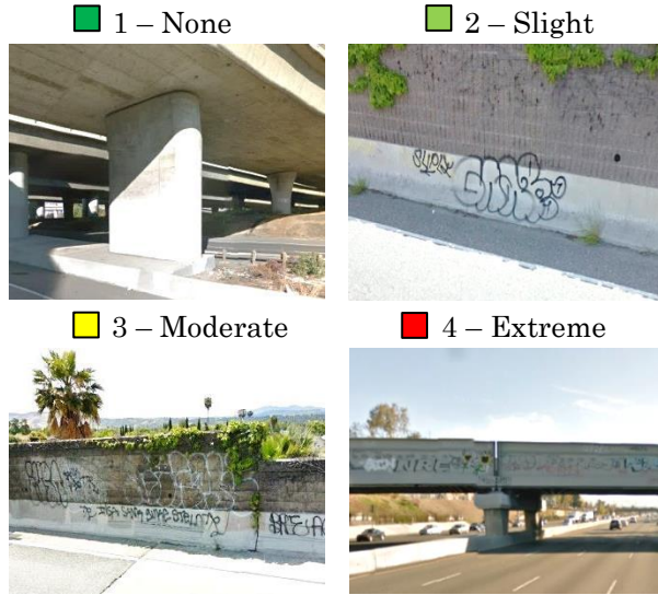
Figure 23. Graffiti Grading Scale.
